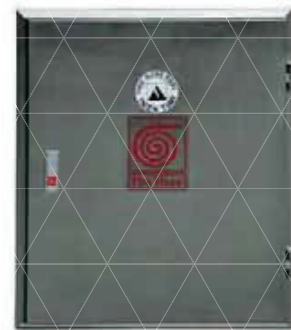
► Fire Hose Reel
